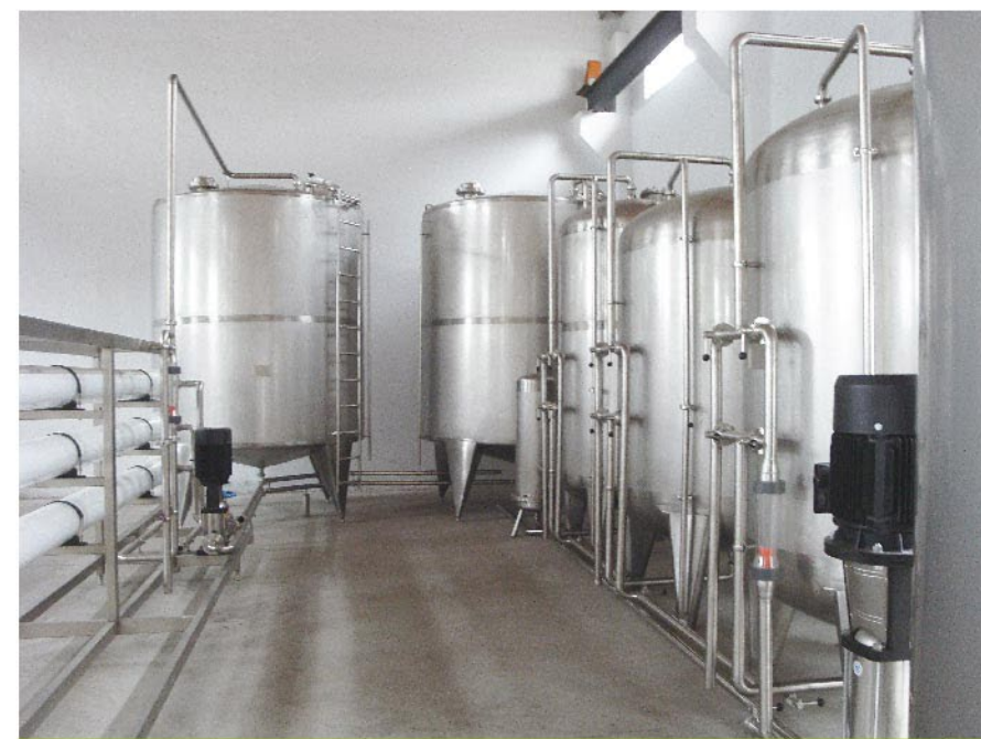
全套水处理系统 Complete Water Treatment System
