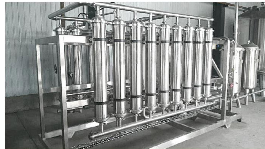
超滤系统 Ultra filtration system
