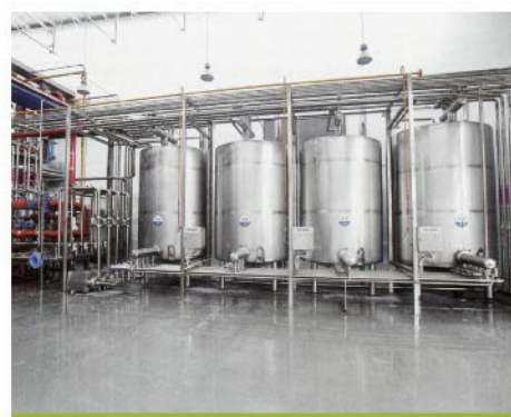
清洗系统 CIP System
